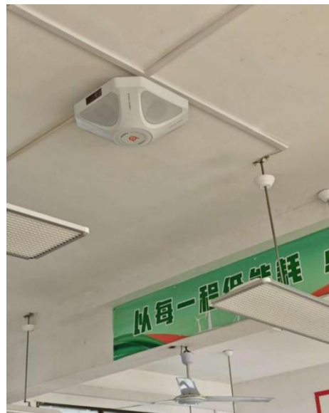
图 6：教室新安装的扩音设备
